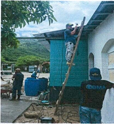
Foto 11: Mejoramiento de techo de la escuela, cambio de lámina en área de Dirección, cocina y área de comedor
