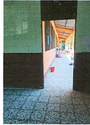
Foto 10: Colocación de 115 m2 de piso de granito más de lo previsto, en Dirección, bodegas y pasillo exterior
